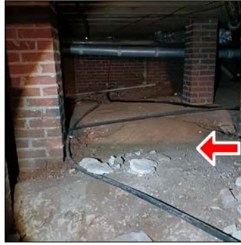
No moisture barrier
