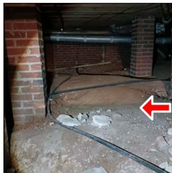
No moisture barrier
